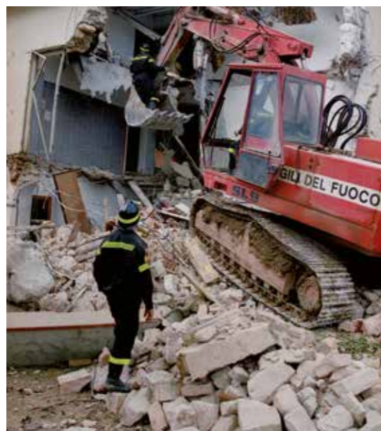
Foto 39. I danni alle abitazioni causati dal terremoto in Umbria e nelle Marche.
