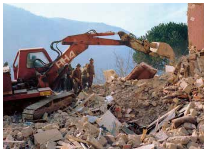
Foto 33. I crolli alle abitazioni causati dal terremoto in Irpinia del 1980.
