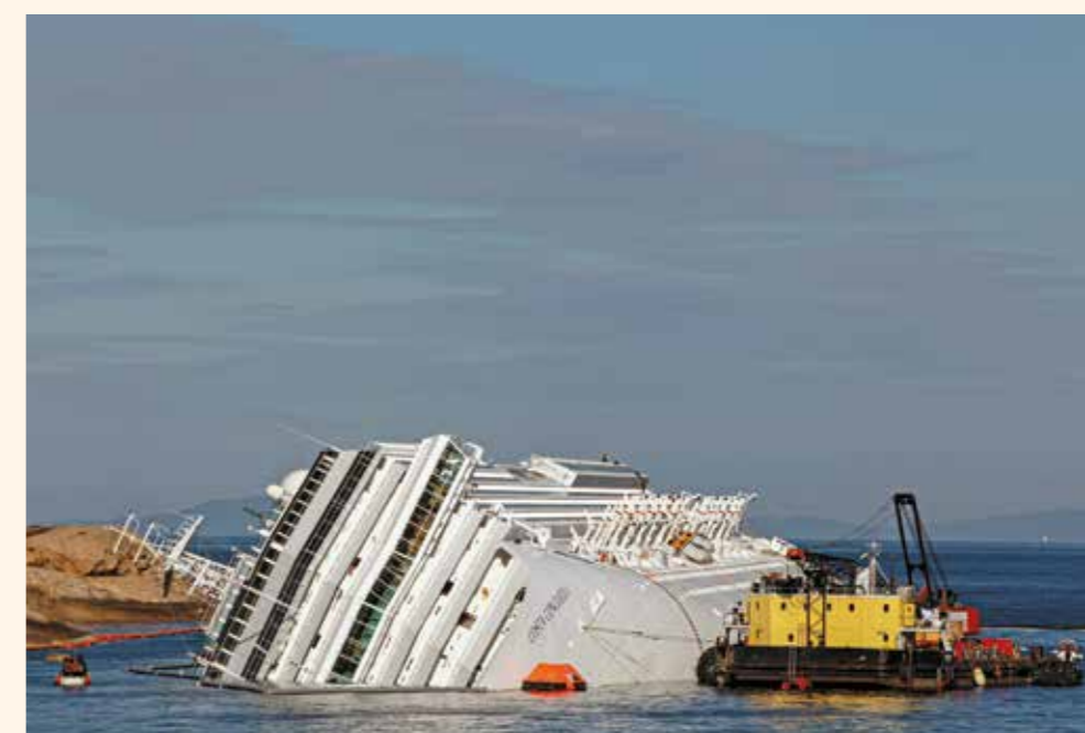
Foto 125. Isola del Giglio, Toscana, 2012. Preparazione dell'area per le operazioni di rimozione della nave.
